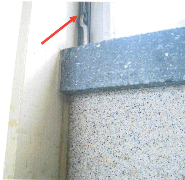
Bild 5: Fugenmasse Stütze/Fensterrahmen, Achse 24, 1.OG
