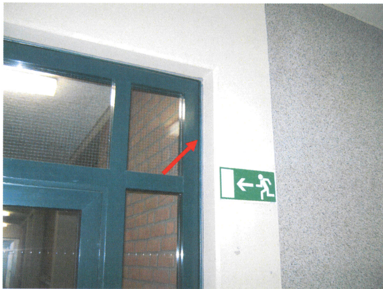
Bild 4: Fugendichtmasse Flurtür/Wand, Achse 21
