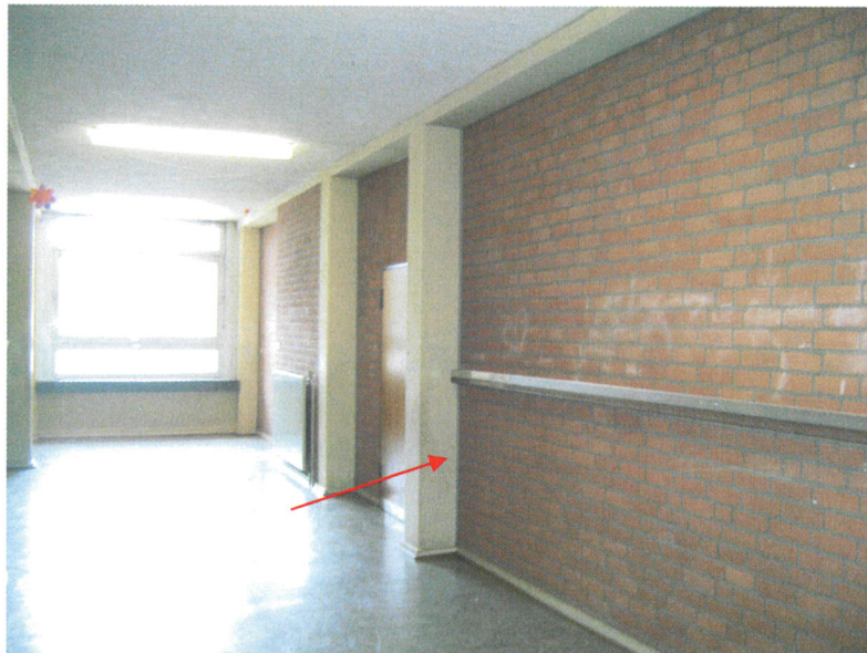
Bild 10: Fugendichtmasse 2.OG, Flur vor Klasse 15, Stütze/Wand
