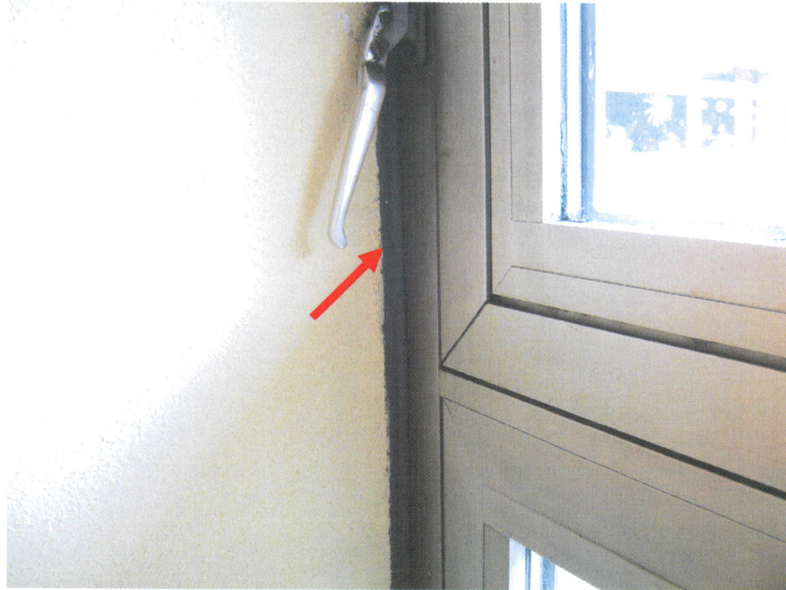
Bild 2: Fugendichtmasse Fensterrahmen/Wand, Raum 3, EG
