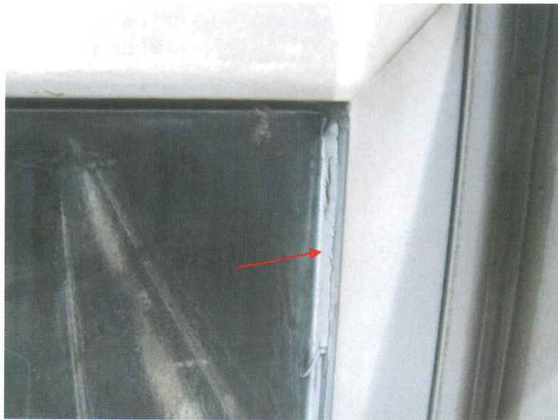
Bild 9: Fugenmasse an der Fensterscheibe, 2.OG, außen
