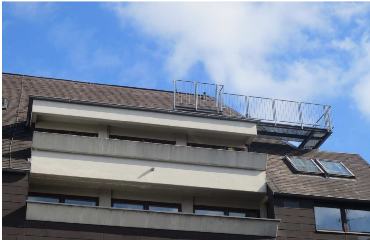
Foto 6: Selbstrettungsweg aus rückwärtiger Nutzungseinheit mit Wartebereich (DIN 14094-Teil2)
