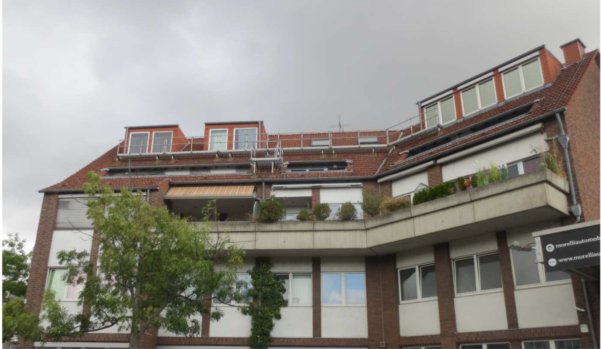
Foto 5: Selbstrettungsweg mit Anschluss an mehrere Nutzungseinheiten (Laufsteg) und Wartepodest (DIN 14094-Teil2)
